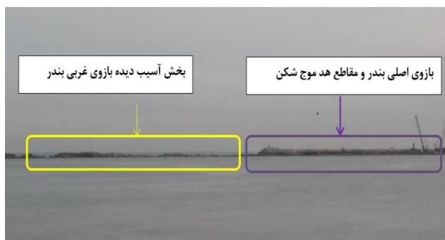
شکل ۱: بخش‌های آسیب دیده موج شکن بازوی غربی در حال اجرا در مقایسه با بازوی اصلی تماماً اجرا شده و آسیب ندیده بندر.
